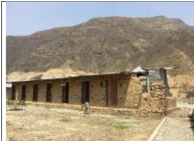
写真 1 再建のめどが立たず、崩れたままの校舎を使用
