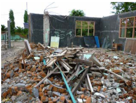
地震で倒壊したままの校舎
